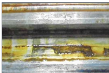
Intrång av vatten eller kylmedel
