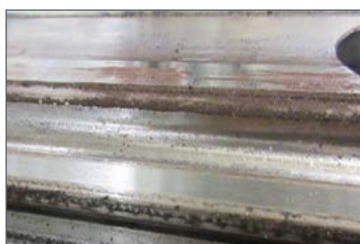
Rost och korrosion
